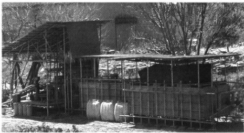
生ごみ資源化プラント
